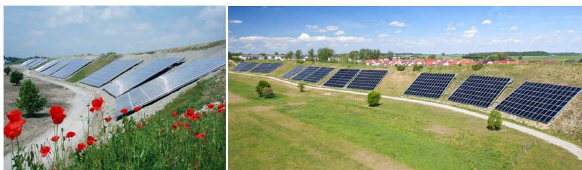
Figure 24 : Champ solaire au sol sur butte à Crailsheim (Allemagne) – 7000m 2 (Source : Solites)
