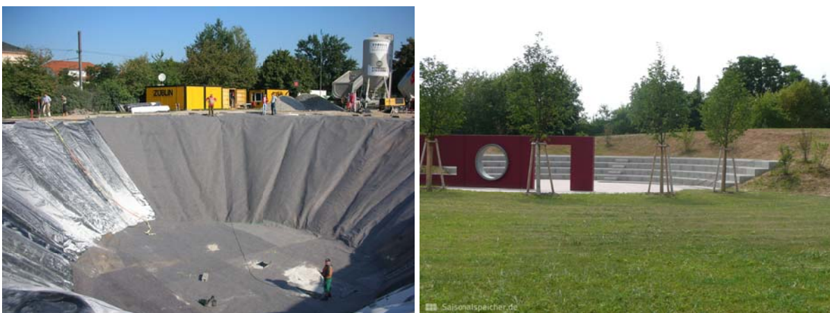
Figure 27 : Intégration d'un stockage PTES à Eggenstein - 4500 m 3 (Source : Solites)
