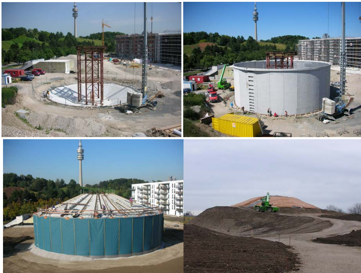
Figure 28 : Stockage en cuve à Munich - 5700 m 3 (Source : Solites)
