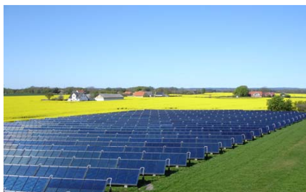
Figure 23 : Champ solaire au sol à Ulsted (Danemark) – 5000 m 2 (Source : Arcon)
