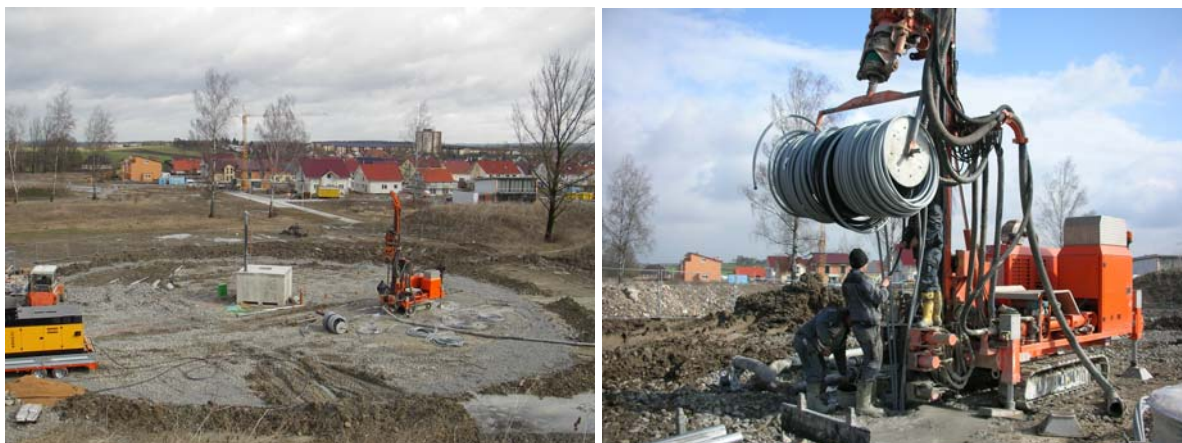
Figure 30 : Stockage en sondes géothermiques BTES à Crailsheim en cours d'installation (Source : Solites)
